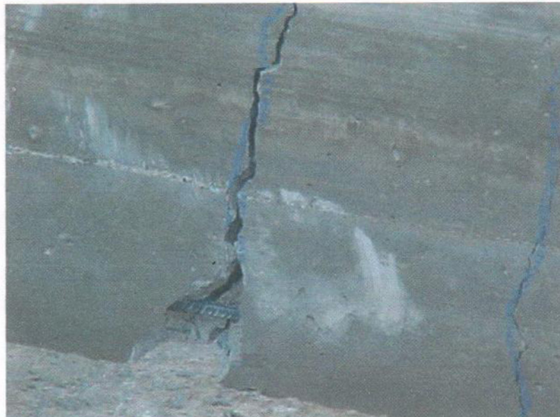
FOTO 03 – Ruptura da Viga (Amostra 01 – concreto Fck 16Mpa).
